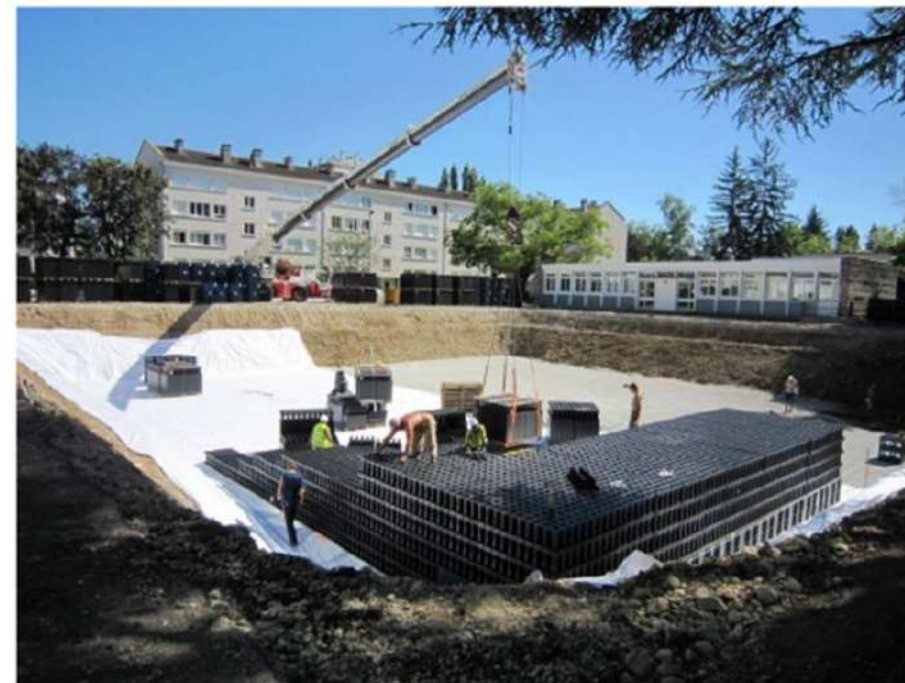
Bassin enterré d'infiltration SAUL – Syndicat Lac Annecy
